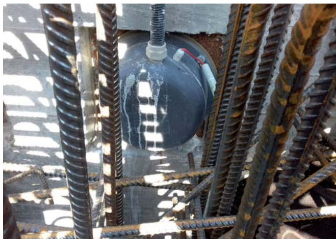
Obr. 6 Ochranný kryt kotvenia s vodičom na meranie elektrického odporu Fig. 6 Protective cover of anchorage with conductor for the measurement of electric resistance
