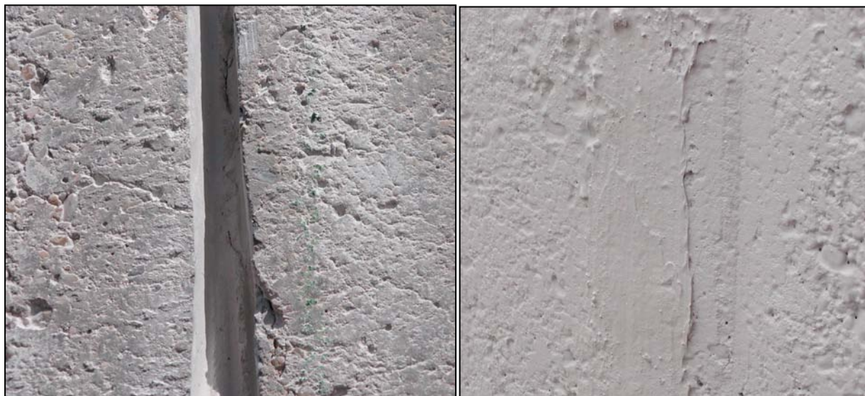
Obr.2. Sanácia veľkých trhlín
