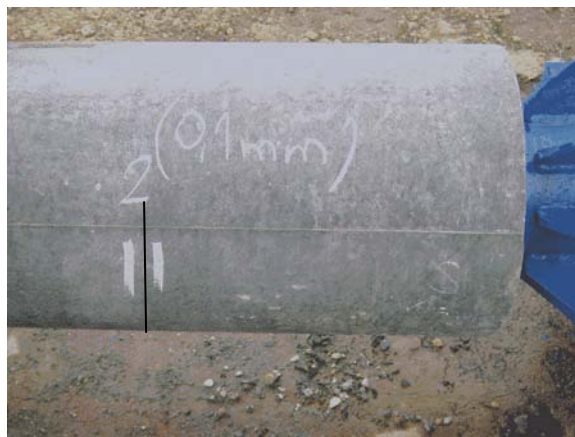
Obr. 8. Prvá ohybová trhlinka
