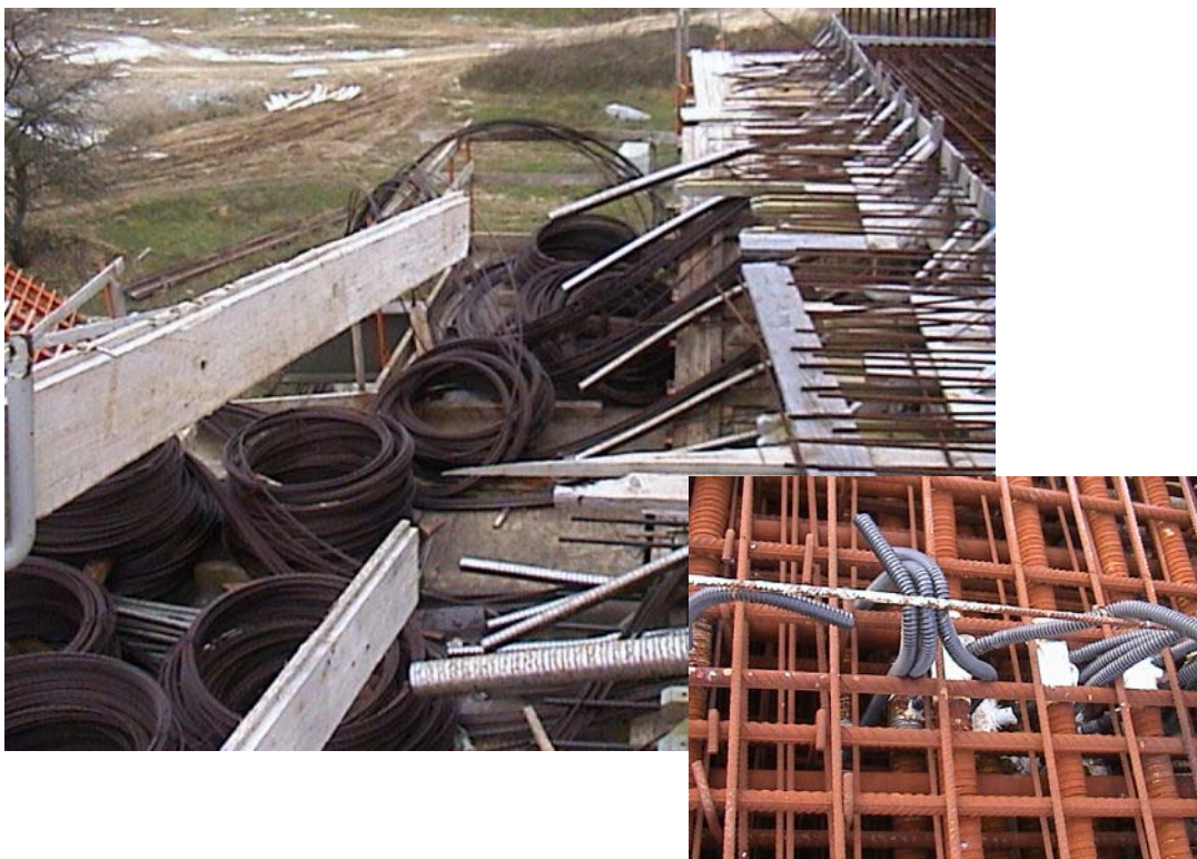
Obr.2 Korózia mäkkej a predpínacej výstuže diaľnica D1-Sverepec
